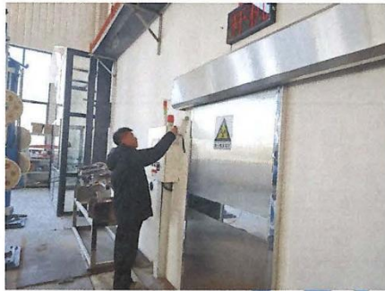
图2 防护门左缝检测照片
